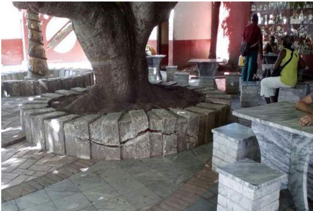
Fig. 1- Daños a la jardinera por las raíces
